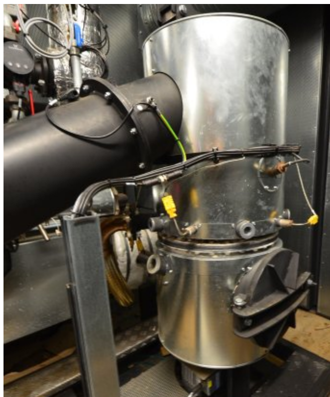
Le gazogène SPANNER de la centrale de Crisnée, photo FD
