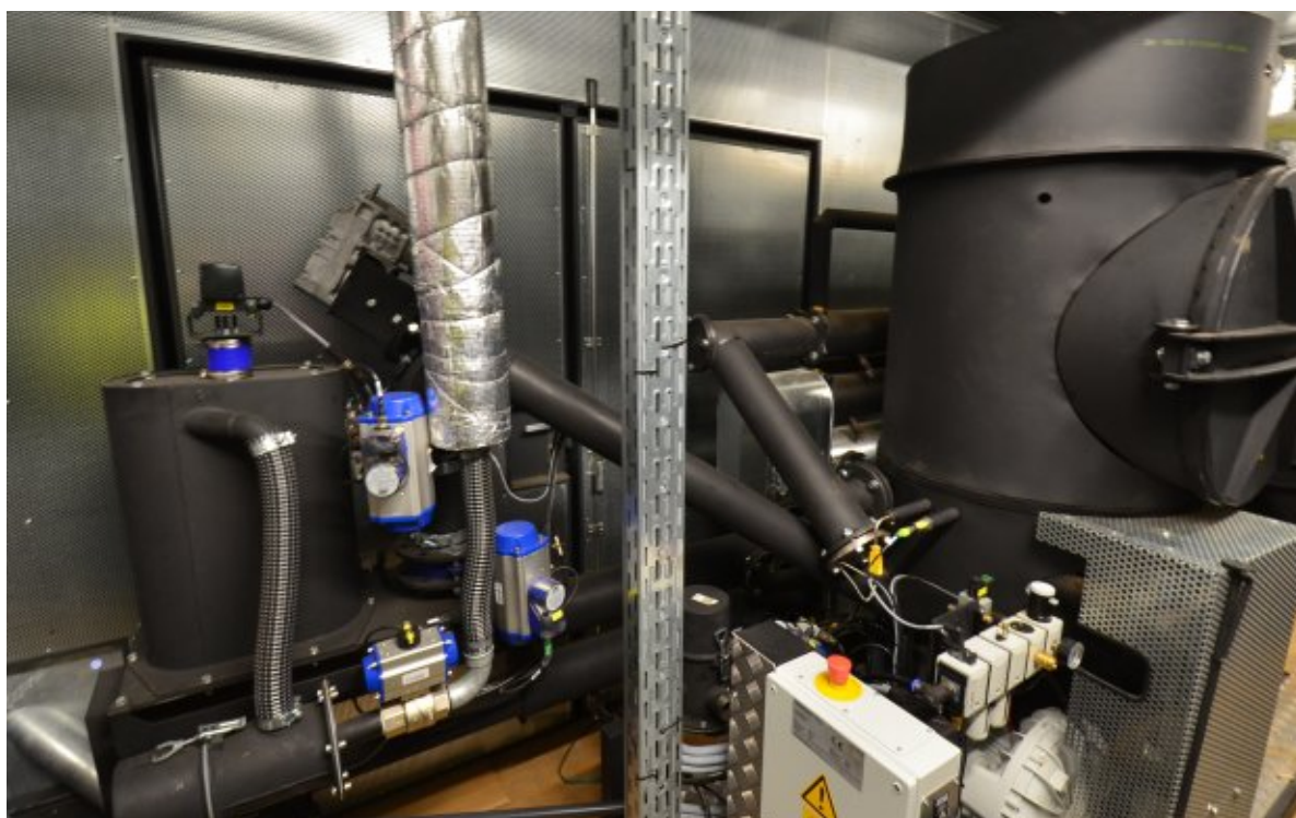
Les équipements de traitement du syngaz dans le conteneur de cogénération SPANNER photo FD
