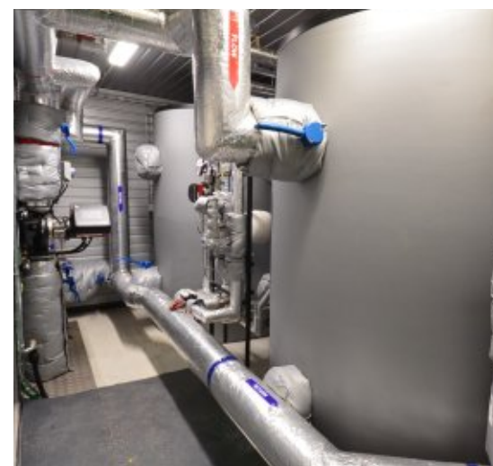
Les deux ballons d'accumulation dans le conteneur chaufferie, photo FD
