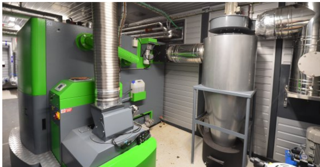
Le conteneur chaufferie avec la chaudière SMART HEATING, photo FD
